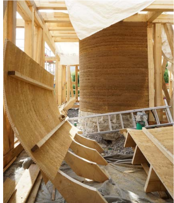
Réalisation d'un système central de stockage d'énergie / creation of a central energy storage system
