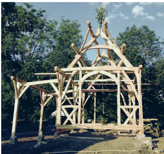
Charpente levée avec le bouquet en faitage / raised framework with ridge cap
