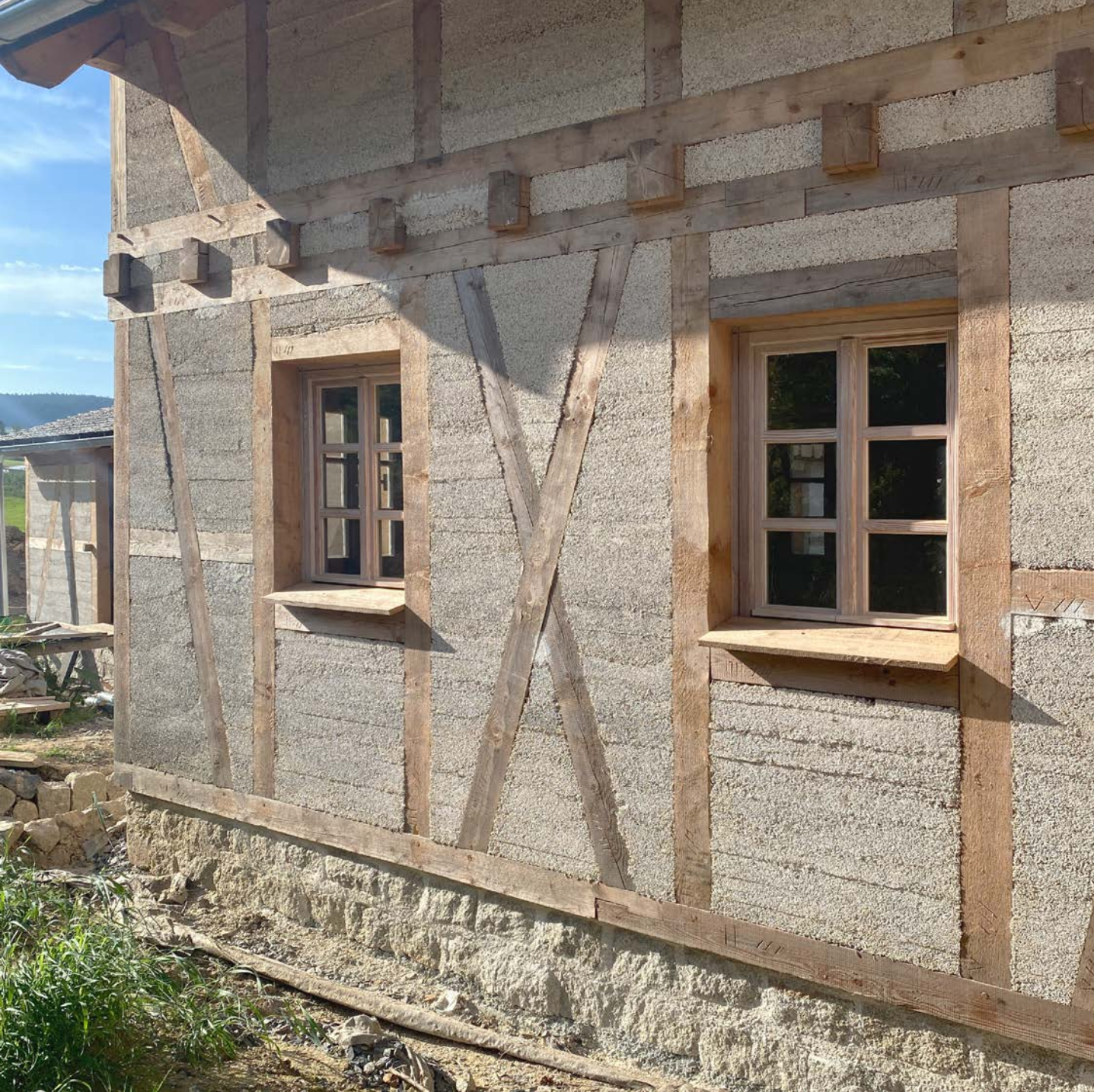
Remplissage du colombage au béton de chanvre / filling the half-timbering with hemp concrete
